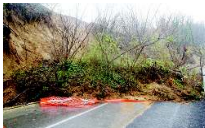
La frana che ha bloccato la strada che collega Bubbio a Cassinasco
